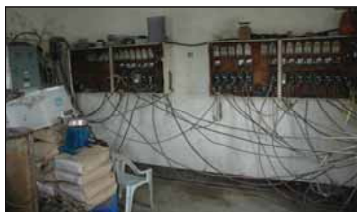
圖 7.12 供電中心應妥善設置，並保持周遭清潔，維持水電設施的安全及便利
