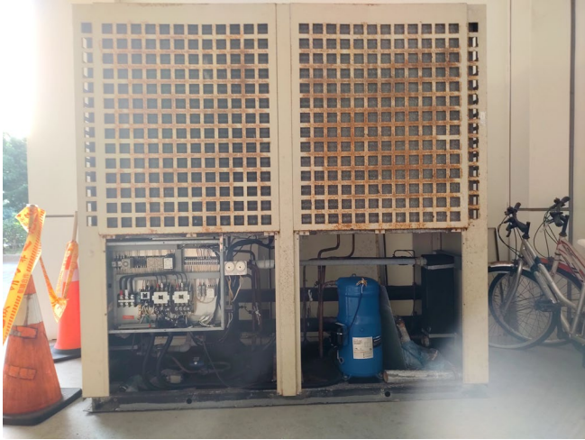
水試所 114 年廢品照片 (064301)007 (20RT 氣冷式冰水主機)
