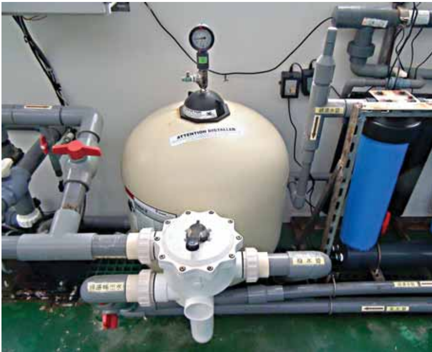
▲急速砂過濾器可有效去除水中的懸浮顆粒、微藻及浮游生物
