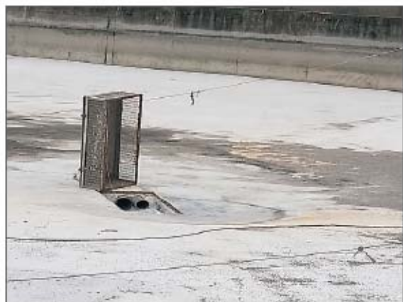
▲ 固定式中央排汙孔設備
