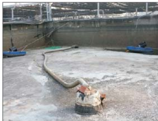
▲ 移動式中央排汙設備
