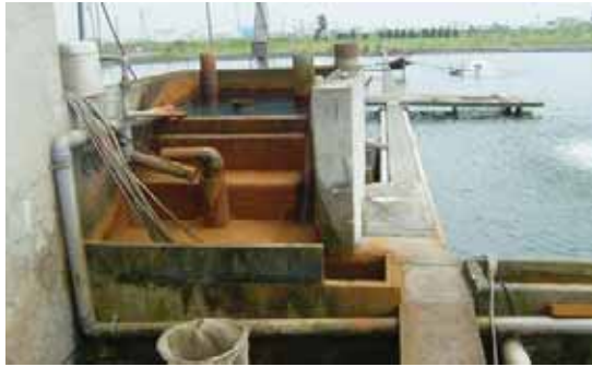
圖 3-13 養鰻池之地面蓄水塔
