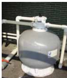
▲急速砂過濾器
