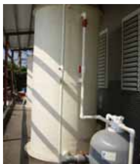
▲大型生物過濾槽
