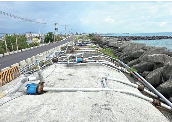
圖 1 技術團隊颱風災後進行堤岸取水管線受損勘查並訪視養殖戶
