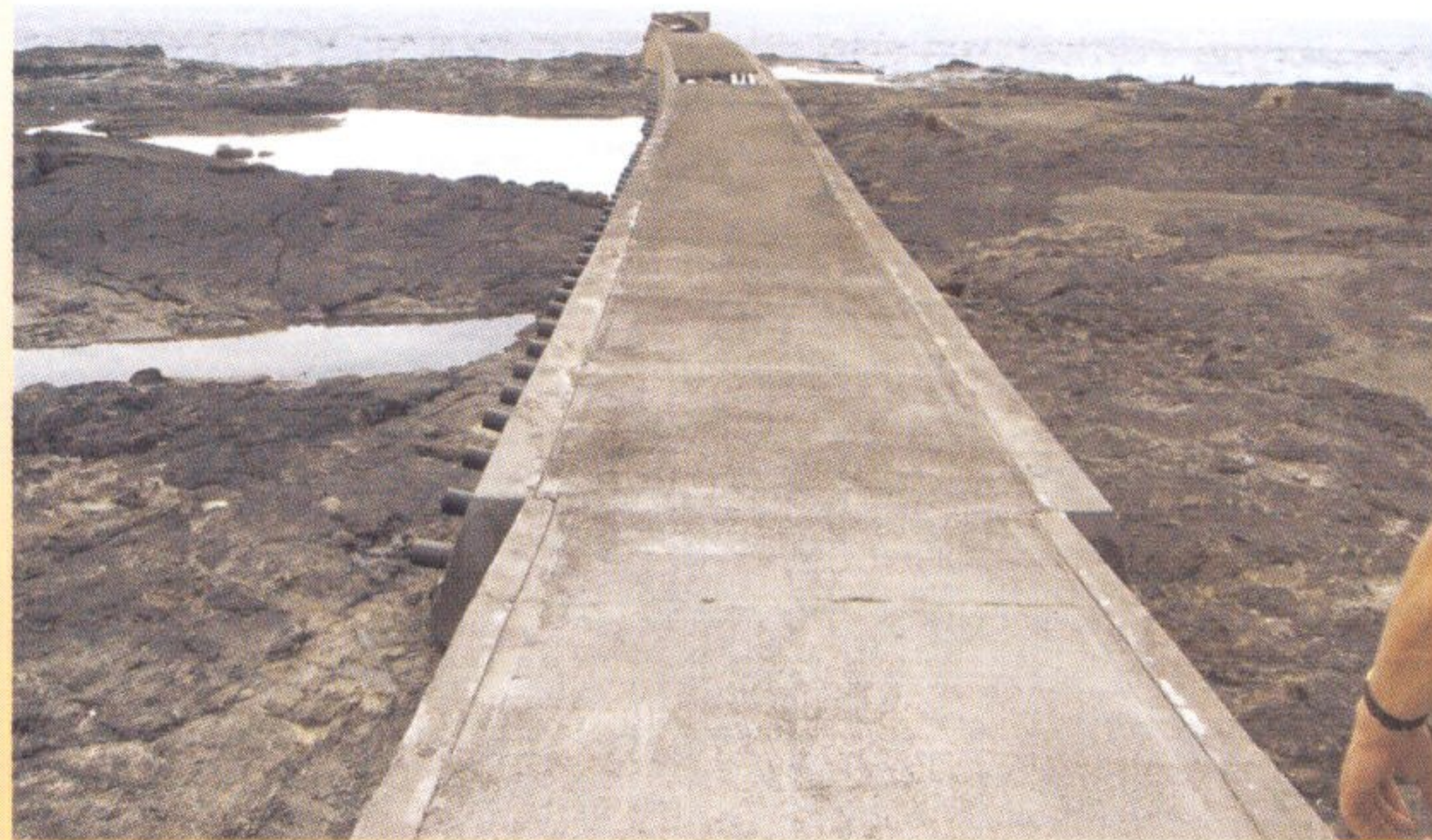
圖 10 深層水取水管陸域之涵洞設施
