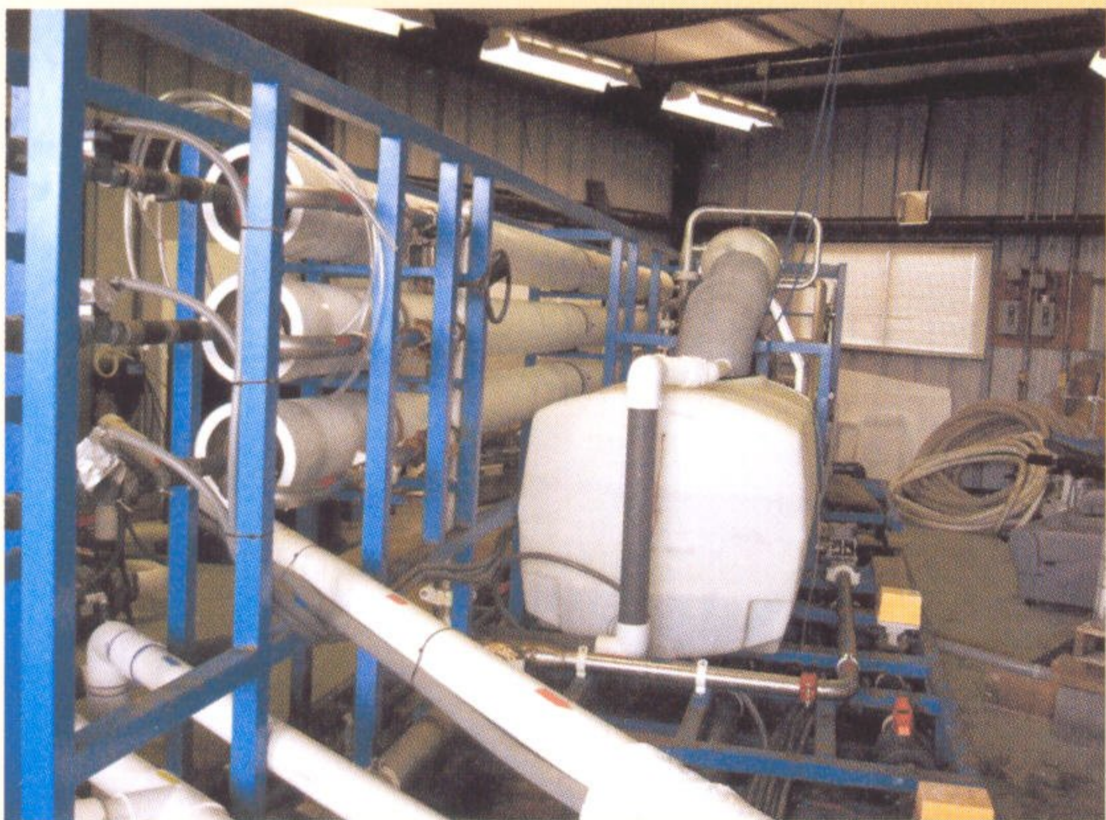
圖 11 夏威夷海洋深層水海水淡化設施
