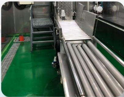
▲ 前處理區(屠宰設備)
